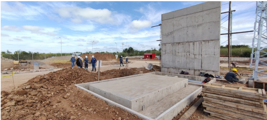
Foto de Archivo - AETN inspecciona obras en la Subestación Bermejo en Tarija
